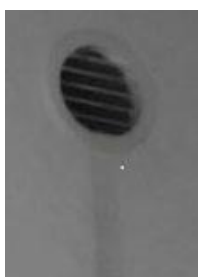
Venkovní mřížka bez uzpůsobení odtoku kondenzátu
